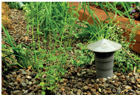
/ Ujęcie rury przelewowej nad powierzchnią ogrodu deszczowego w Wielkiej Wsi // fot. Kuba Kopecki, Fundacja Sendzimira
